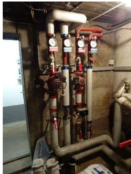
Distribution de chauffage
