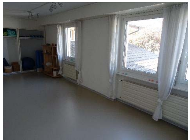
Radiateurs locaux administratifs
