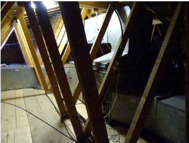
Monobloc de ventilation salle de spectacle
