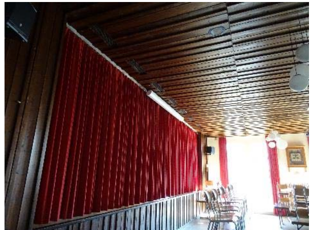
Grilles de pulsion salle de spectacle
