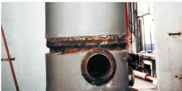
Matériaux d'isolation amiantés pour chaudière
