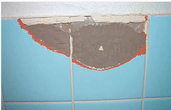
Parois enduites de colle à carrelage amiantée
