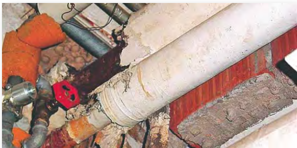
Mortier amianté souvent enveloppé dans de la toile de jute pour l'isolation de conduites
