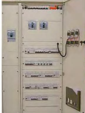
Fig. 5 Tableau électrique de distribution principal
