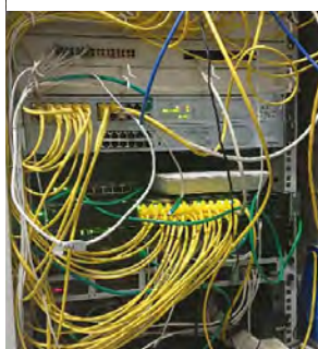
Fig. 1 Patch panel avant mise à niveau
