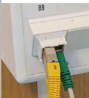
Fig. 2 Connexion réseau avant mise à niveau
